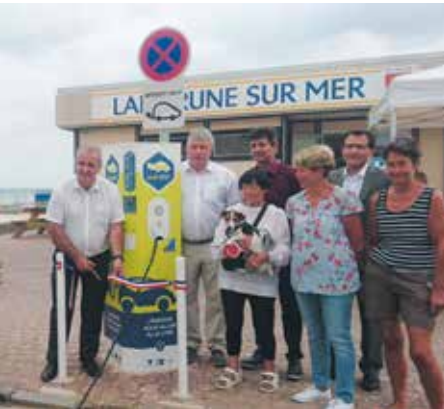
Borne de recharge pour voiture électrique. Inauguration le 19 juillet 2017.
